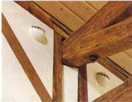
Zuluftdüsen im Decken- und Wandbereich
