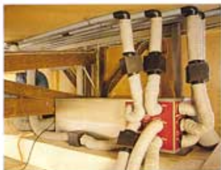
Wärmetauscher mit Anschluß der Luftleitungen und Schalldämpfer im Dachraum
